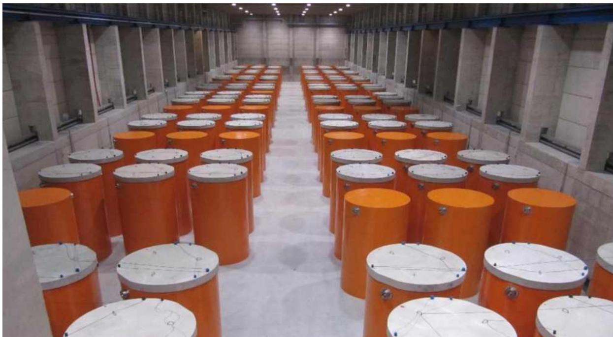
Рисунок 3.2-3. Зал хранения бочек ОЯТ в ВХОЯТ-2.
