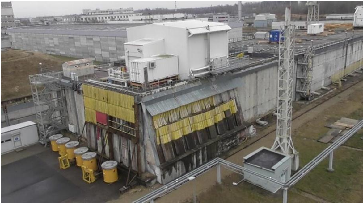
Рисунок 3-1. Здание хранения № 157 ИАЭС для эксплуатационных ТРО с установкой извлечения ТРО группы G3 (установка извлечения УИ-3)
